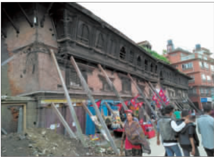
尼泊爾加德滿都東側古城巴塔普爾(Bhaktapur)的世界遺產杜巴廣場(Durbar Square)附近因去年強震損毀的民宅，災民因沒錢重建，暫時以木棍支撐要倒塌的牆繼續居住。
