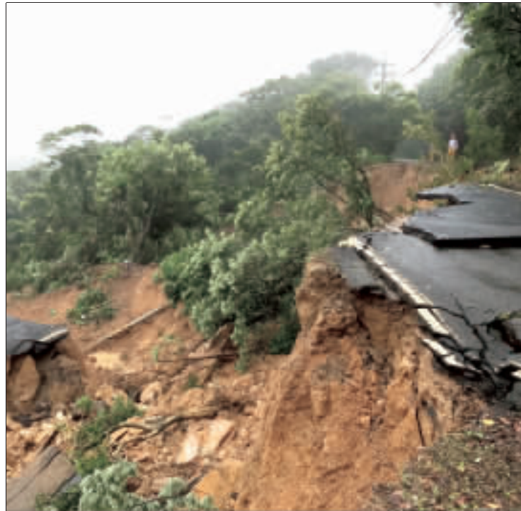
受到西南氣流及滯留鋒面影響，基隆市德安路街接情人湖產業道路山坡土石滑落，路面嚴重坍塌，目前道路無法通行，警方已到場拉起封鎖線，禁止人車通行。（中央社）
