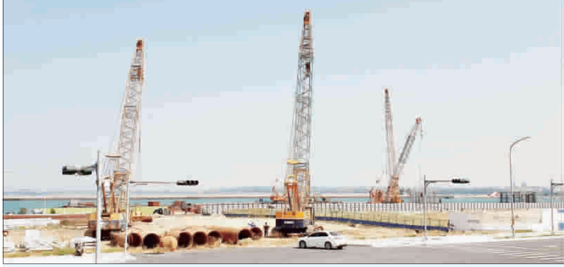
左、水頭服務中心新建工程廠商驚傳跳票，工區停擺；右、水頭服務中心得標廠商跳票。
