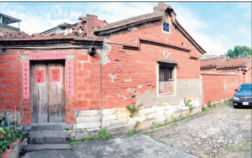
上、見證北投石牌地區開拓歷史的魏厝鉅鹿堂，因建築體已殘破不堪，加上多數所有權人極力反對，未能獲得文資身分，如今產權由建商整合，即將拆除改建大樓；下、見證北投石牌地區開拓歷史的魏厝鉅鹿堂即將被拆除改建，嘆哩岸文化工作室創辦人李庚霖表示，希望當初所有權人在文資會上承諾保存鉅鹿堂堂號門匾區能被貫徹。(李庚霖提供/中央社)
