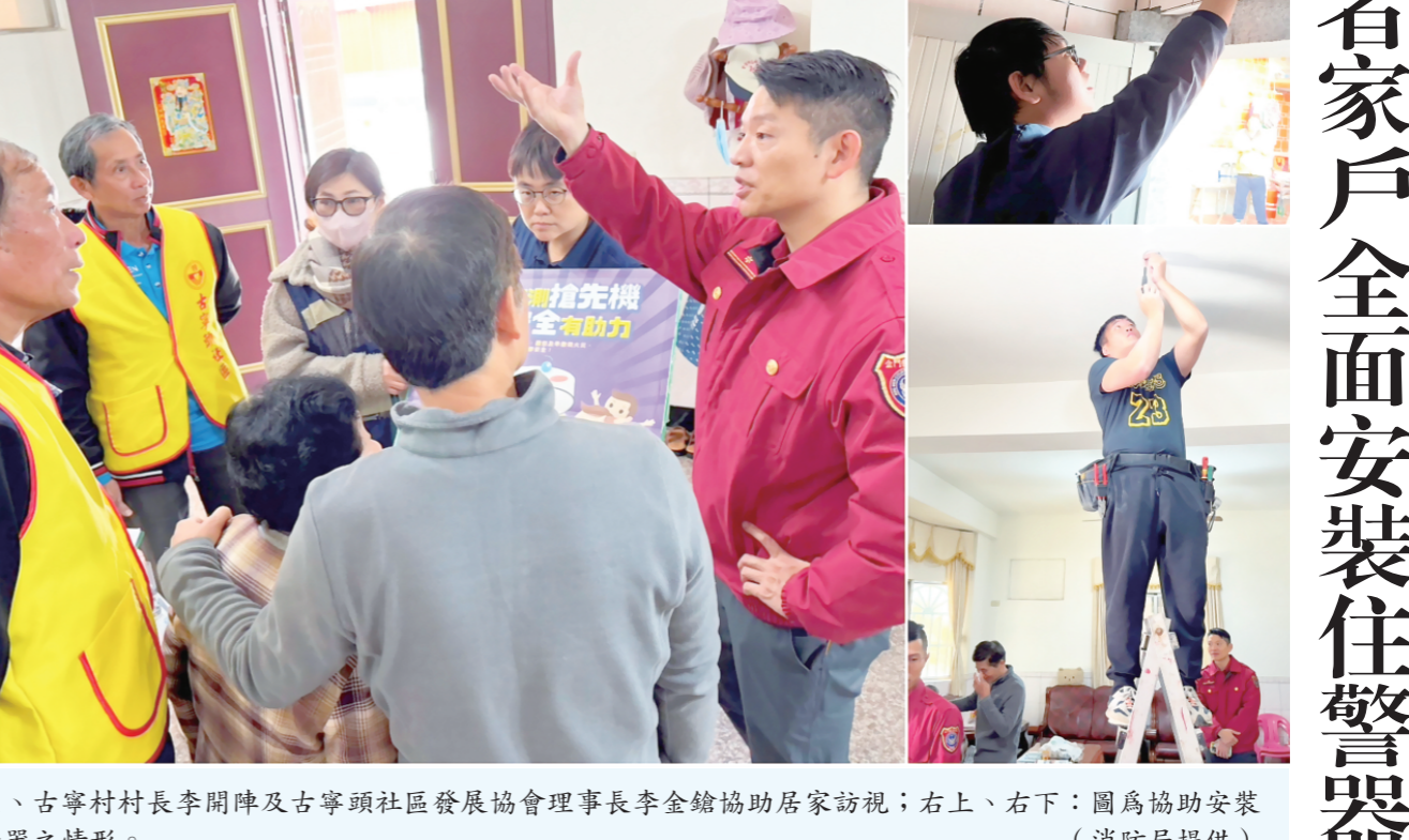
左、古寧村村長李開陣及古寧頭社區發展協會理事長李金鎔協助居家訪視；右上、右下：圖為協助安裝住警器之情形。(消防局提供)
