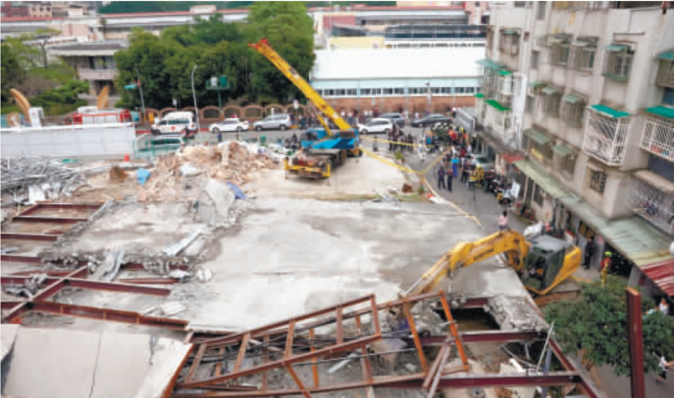
台北市士林區一處預售屋銷售中心30日執行拆除作業時發生樓地板塌陷意外，一名山貓駕駛因來不及逃出而死亡，同時有部分結構掉落在鄰近巷道，目前已拉起封鎖線進行管制。（中央社）
