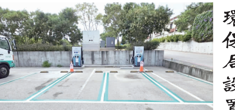
金門縣環保局停車場與尚義機場低碳館停車場，已設置快充充電樁服務點。（環保局提供）
