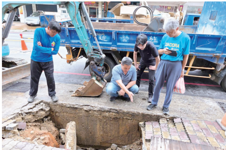
金城鎮民權路上發生路面坍塌，鎮長李誠智前往瞭解。（許峻魁攝）
