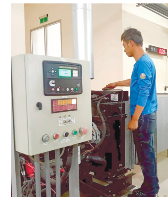
抽水站確認機具可以正常運作。（金沙鎮公所提供）
